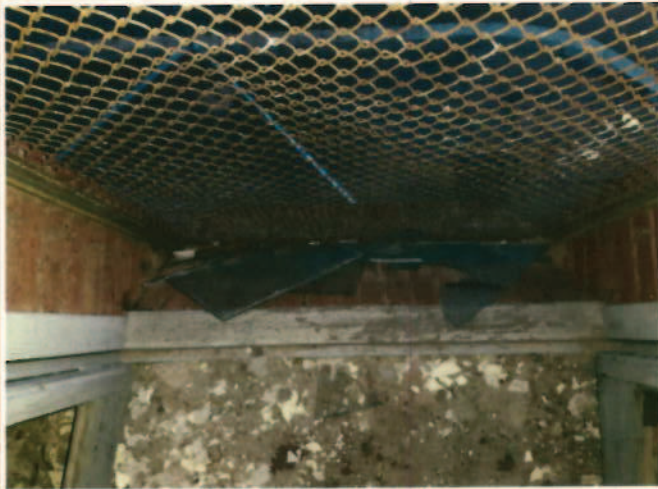
Vidres trencats per les ventades de les finestres de façana de l'edifici de l'Andana
