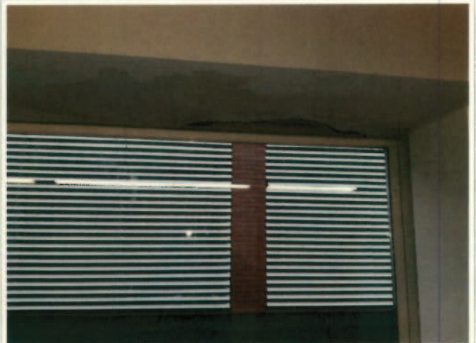
Filtració d'aigua per les juntes de les finestres, despreniment del revestiment interior humit de la biblioteca central
