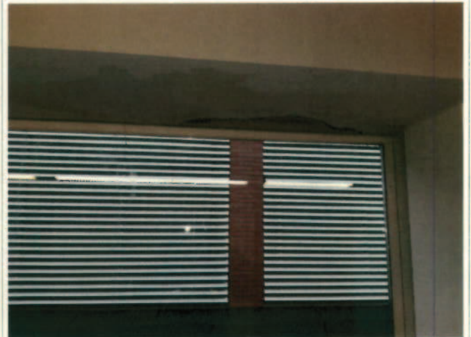
Filtració d'aigua per les juntes de les finestres, despreniment del revestiment interior humit de la biblioteca central
