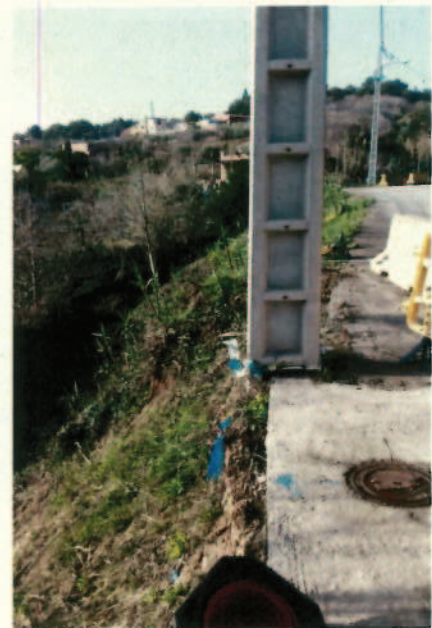
Despreniment de talús al carrer Mas de la Morada entre els números 14 al 21
