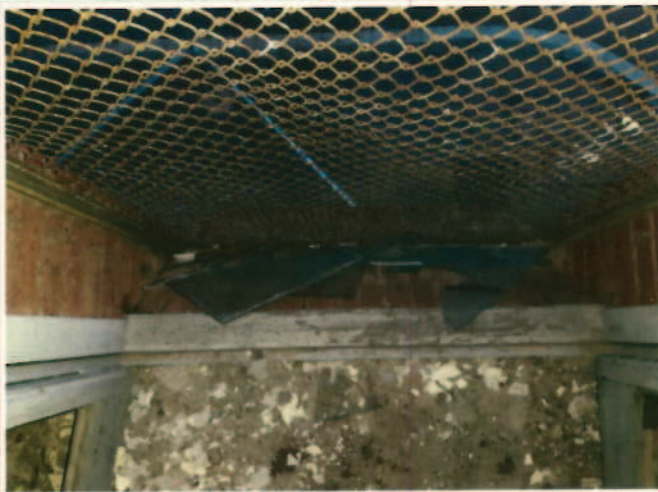
Vidres trencats per les ventades de les finestres de façana de l'edifici de l'Andana
