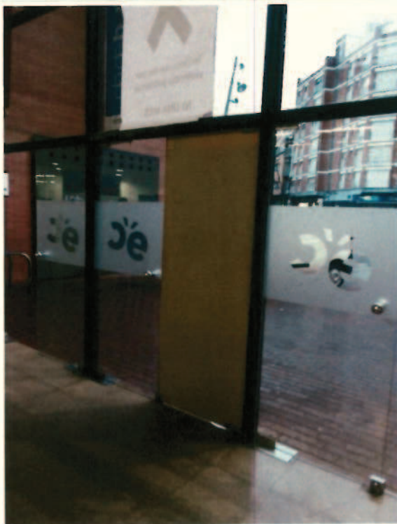
Vidre trencat de la porta d'accés al vestíbul principal del Centre Cívic Montserrat Roig
